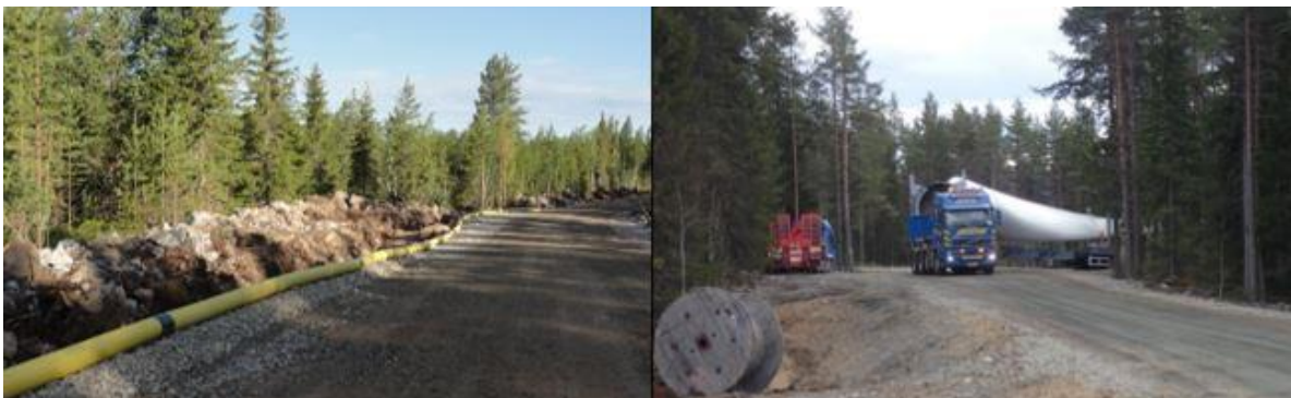
Kuva 4.7 Vasemmalla esimerkki tuulivoimapuiston rakennus- ja huoltotiestä. Oikealla tuulivoimalan osia kuljetetaan erikoiskuljetuksina (FCG).
