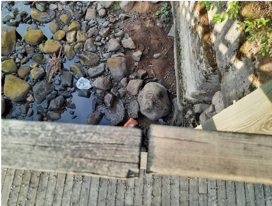
Kuva 11 Sillankaiteen yläjohteen vakava irtoama
