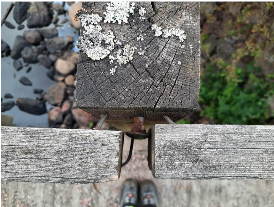
Kuva 12 Sillankaiteen yläjohteen vakava irtoama
