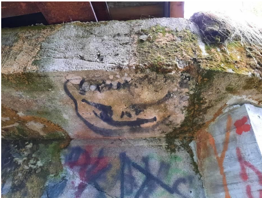
Kuva 6 laakeripalkkien suuntaumatonta halkeilua
