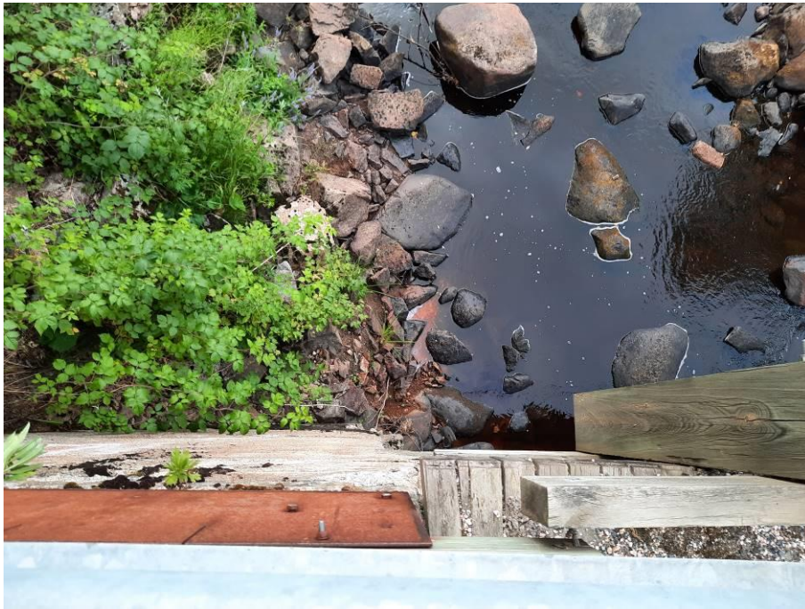
Kuva 13 Korkea sillankaide liian lyhyt, pengerkaide irti siltajohteesta
