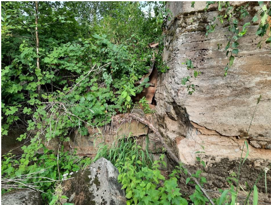
Kuva 16 keillojen eroosioaurioita, tukimuurin 1 oikea rapautumaa
