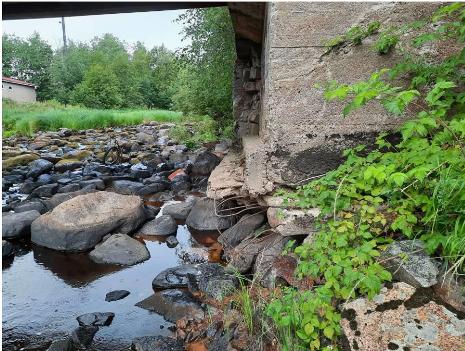
Kuva 18 erittäin vakava rapautuma- ja eroosiovaurioita tuella 1, vasen kulma "ilmassa", sortumariski
