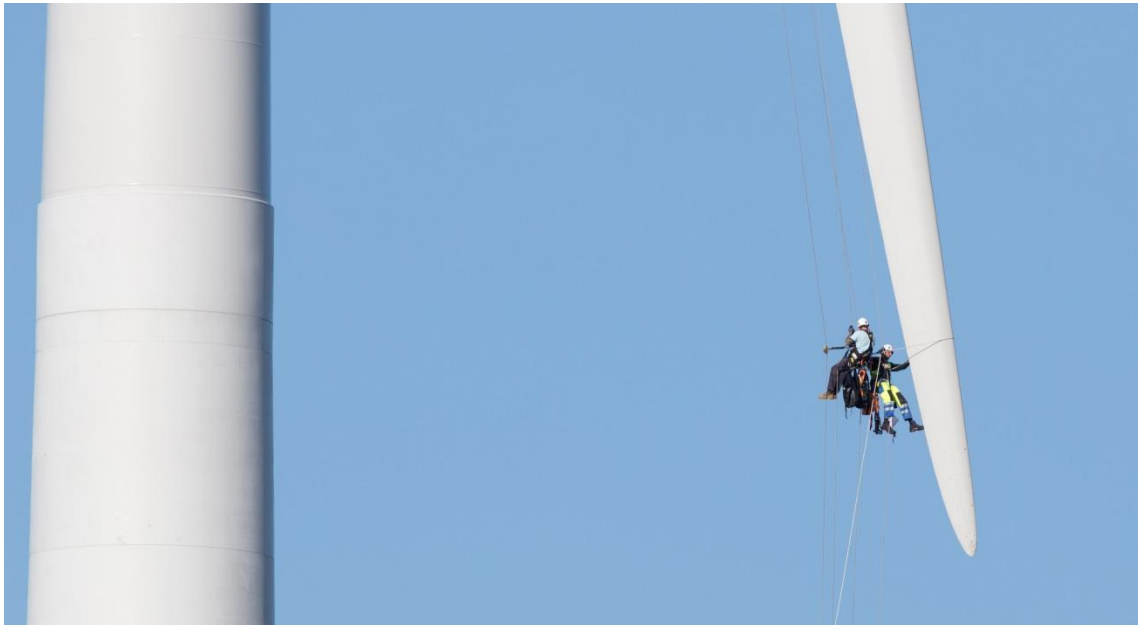
Kuva 4-17. Tuulivoimalan huoltotoimenpiteitä. (Kuva: FCG).
