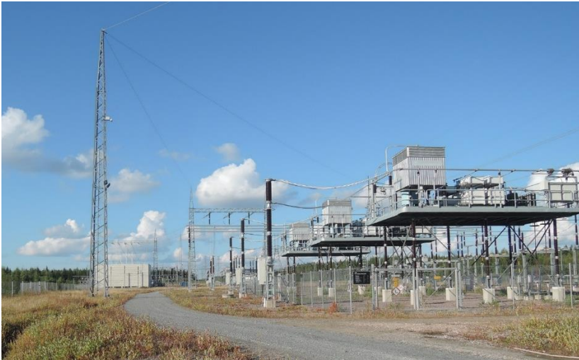
Kuva 3-1. Uusnivalan sähköasema. Kuva 12.8.2021. © AFRY Finland Oy.
