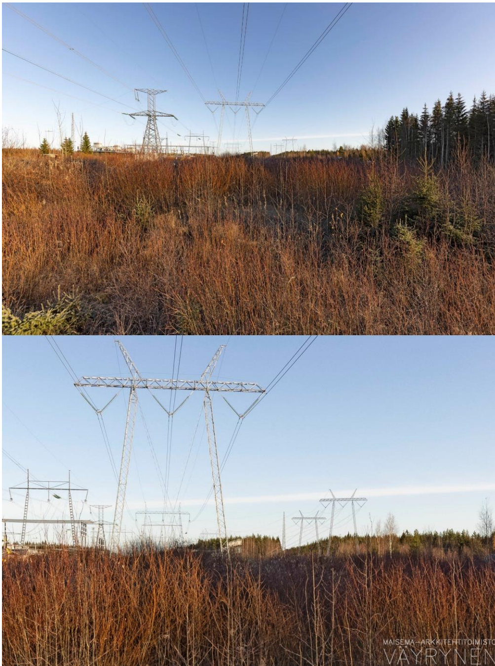
Kuva 8-9 (C). Näkymä voimajohtoihin Uusnivalan sähköaseman eteläpuolelta junaradalta, kuvattuna pohjoisen suuntaan. Hankkeen voimajohto näkyy oikeanpuolimmaisena (yläkuvan objektiivi 16 mm ja alakuvan 50 mm).
