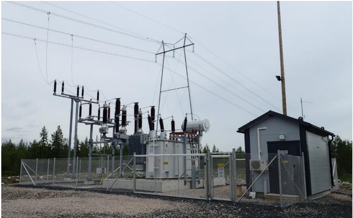
Kuva 5.7. Esimerkki tuulivoimapuiston sähköasemasta 110 kV. (kuva Minna Takalo/FCG).
